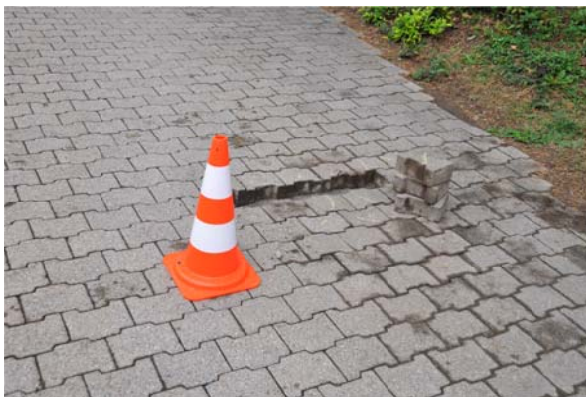
Abbildung 3 - Absenkungen im Verbundsteinbelag
